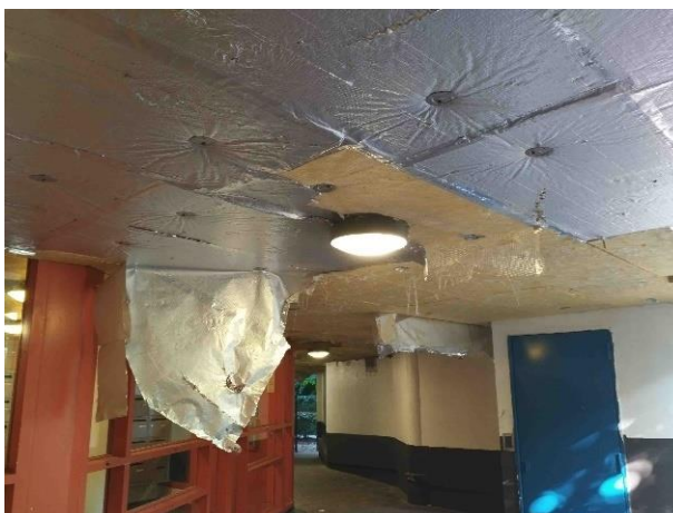
Plafond dégradé devant salle de réunion
