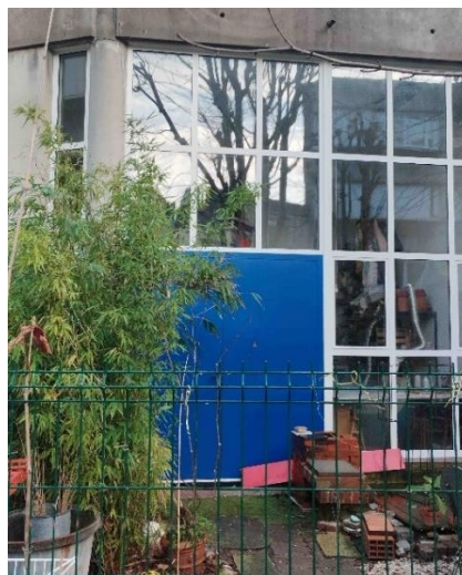
Façade réhabilitée sans respect de la nomenclature d'origine
