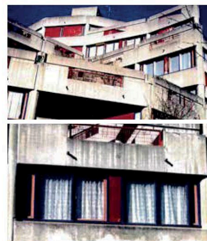
↑ Élévation et photos de l'état en 1995, tranche 1 [Diagnostic enveloppe BERIM 1995]
