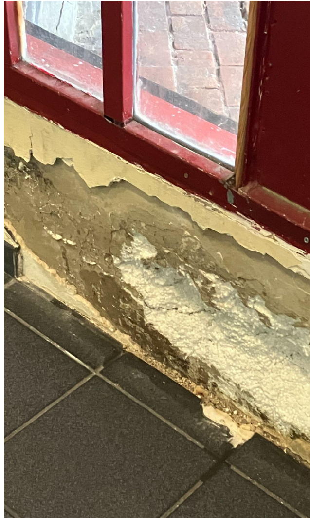
↑ exemples paroi de hall endommagée (tranche 5B)
