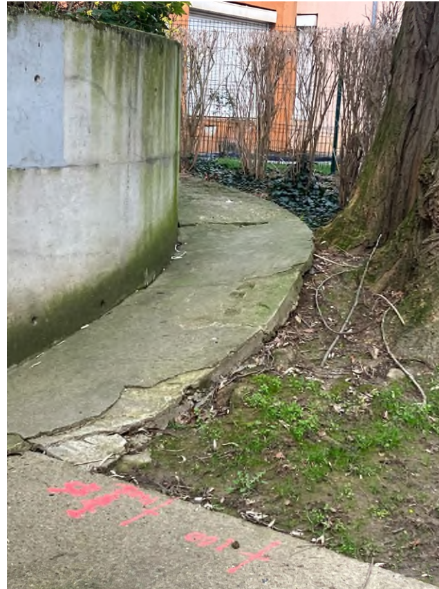
↑ cheminement dallé détérioré en tranche 4
